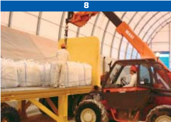
• Dans l'alvéole, le big-bag est déchargé à l'aide de l'engin de manutention.
