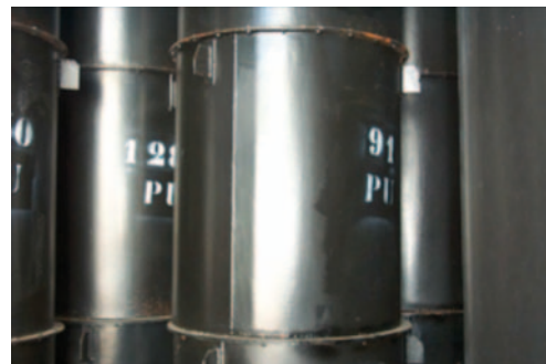
Conteneurs métalliques de déchets solides
