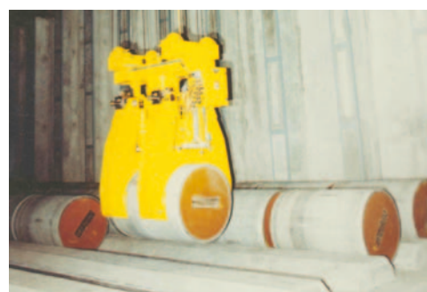
Alvéole d'entreposage des CAC
