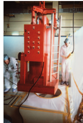
Puits d'entreposage et hotte de manutention
