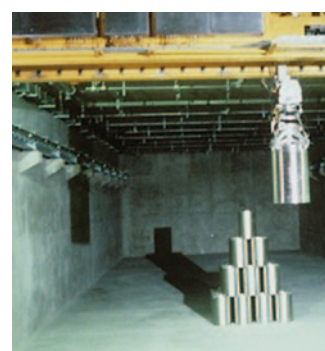
Entreposage des colis d'enrobés bitumineux
