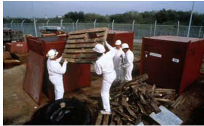
3 - Conditionnement de déchets TFA en caissons métalliques (palette), Brennilis
