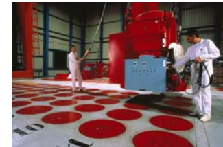
26 - Hall de vitrification, usine de retraitement COGEMA Marcoule
