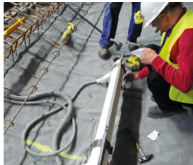
Test d'Evertherm dans une galerie du Laboratoire souterrain de l'Andra en Meuse/Haute-Marne.
