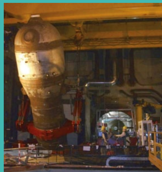
Les générateurs de vapeurs de la centrale EDF de Chooz A : des déchets de grandes dimensions.
