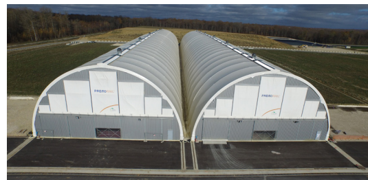
Installation du Premorail® sur deux alvéoles de stockage au Centre industriel de regroupement, d'entreposage et de stockage (Cires) de l'Andra dans l'Aube.
