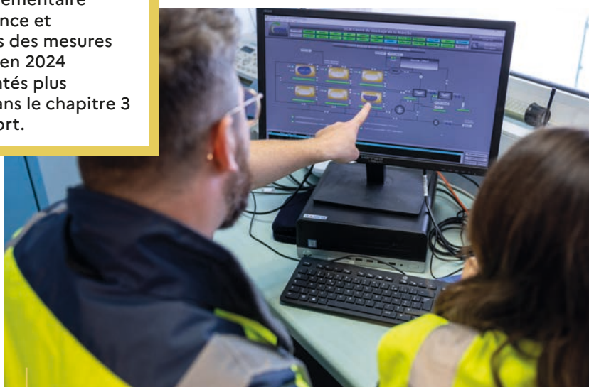
Centralisation des mesures
