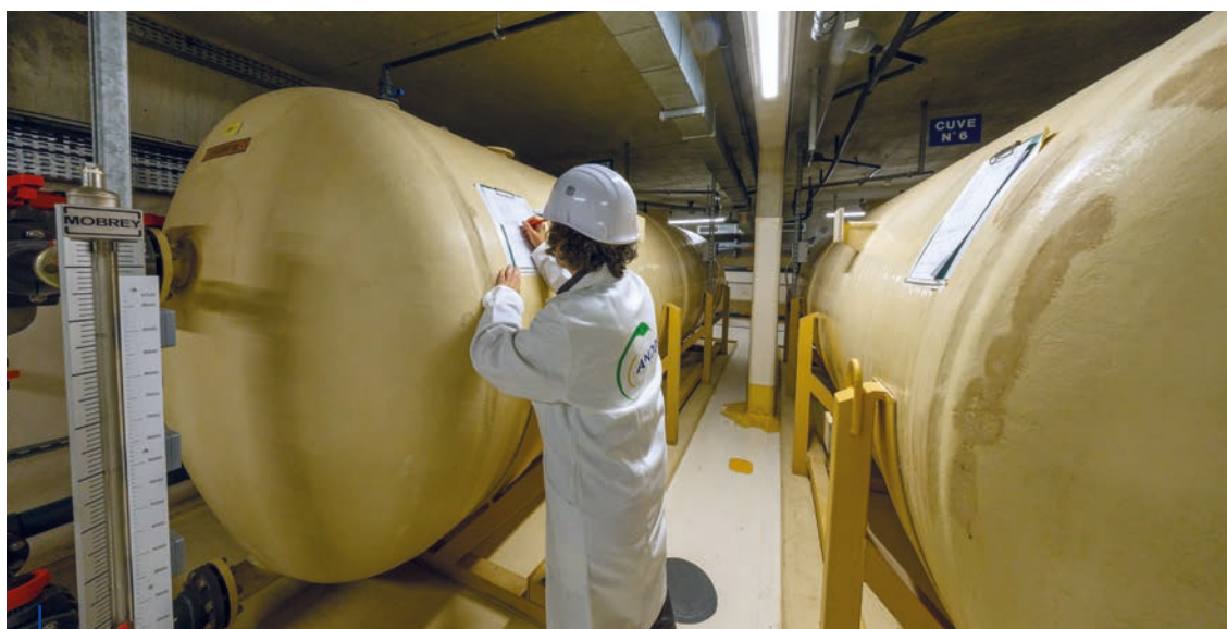
Cuves de collecte des effluents à risque
