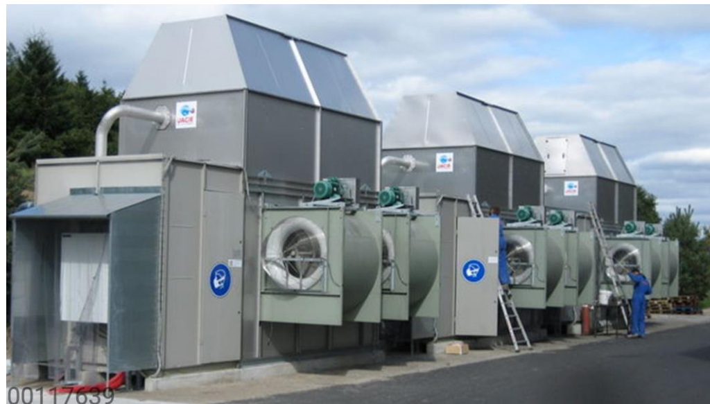
Figure 3-5 Photographie illustrative de refroidisseurs à circuit fermé
